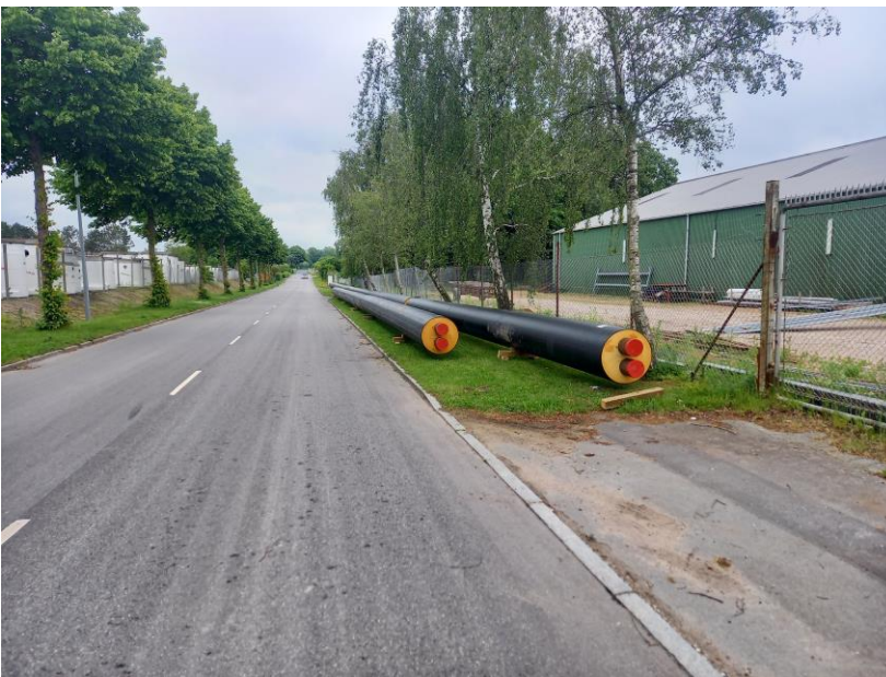
Figur 1 - Fjernvarmerør \varnothing 219 til transitlejningen mellem Ringe og Ryslinge
